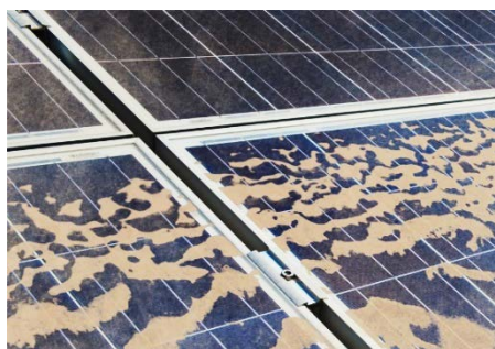
figure 17 : modules couverts de salissures.
